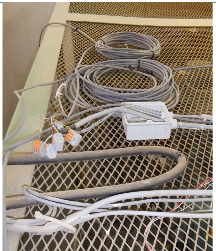
Arrivée des 2 câbles UTP et connexions sur Schwamle sur les câbles d'origine
