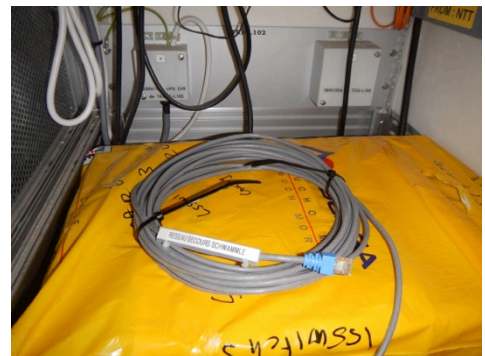
Câble UTP cat.5 côté Armoire ResInfo L102
