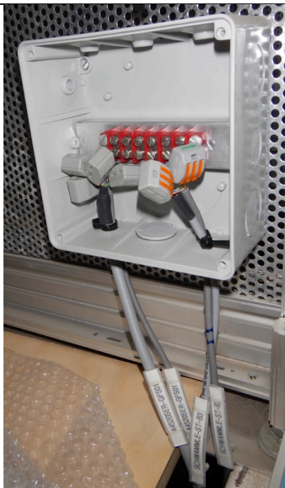
Arrivée dans l'armoire RESERVE et câblage sur les câbles d'origine
