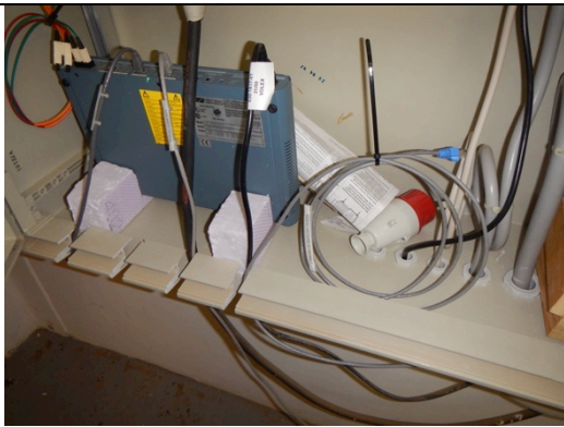
Câble UTP cat.5 côté TEEG-L401
